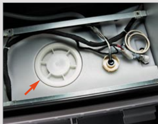
Reinigungsöffnung des Frischwassertanks
