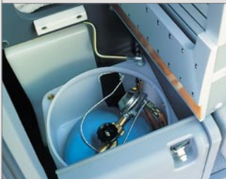
Gasanlage unter dem Drehschrank
